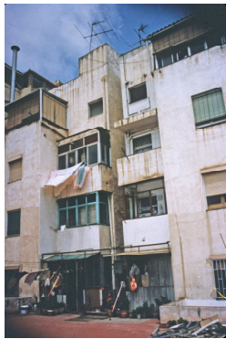
Carrer Foc Follet – estado inicial
